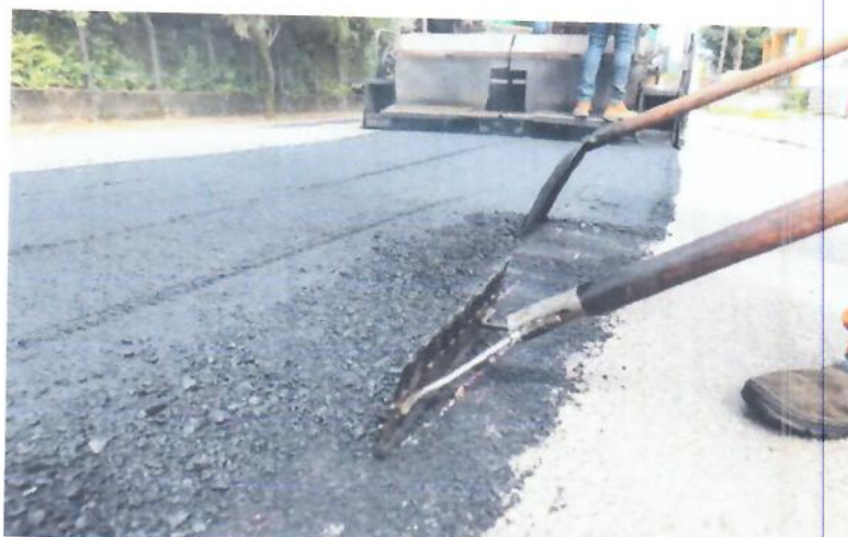
Prefeitura de Joinville alega que obras de recapeamento e pavimentação estão em andamento em 26 ruas (Foto: Mauro Schlieck, Arquivo Pessoal)
